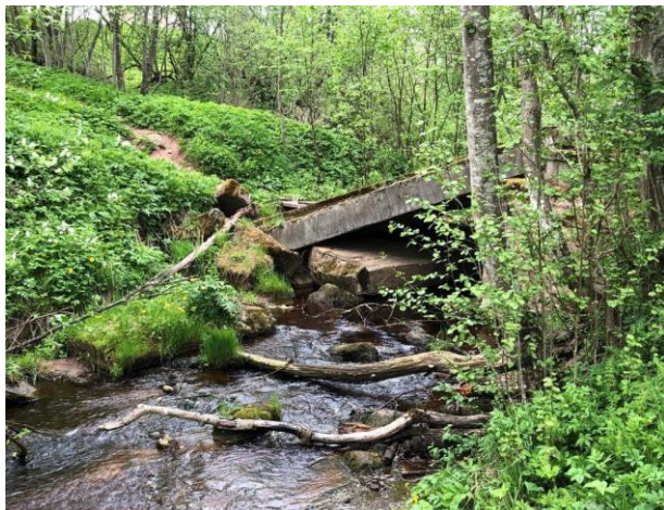
Рисунок 3.5.1. Разрушенный бетонный мост, р. Ящера- д. Пехенец
