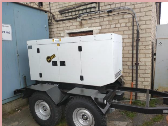
Приобретение дизель-генератора для резервного энергоснабжения в котельную д. Иссад, мкр. ЛТЦ-4
